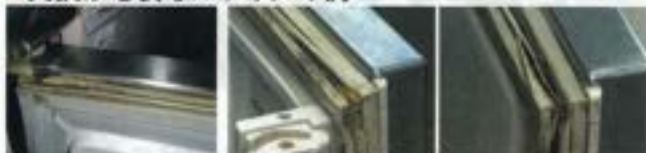
汚れ固着・黒カビ発生
